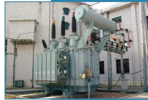
河南禹州电业局110kV变电站
